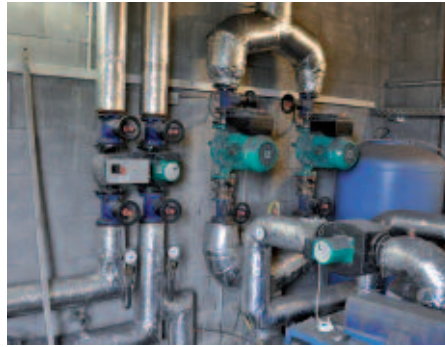
Zentrale Wärmeverteilung im Heizwerk auf dem Biomassehof.
